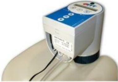
Kuva 12. Fosforinpoistopumppu ja kemikaalikanisteri
